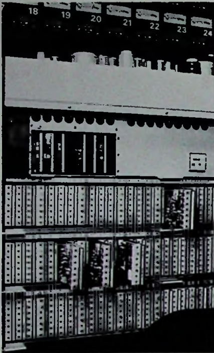
Bild 6. Bei den aufwendigen Studiomaschinen füllen die Verstärkereinschübe einen ganzen Schrank. Für den Service sind sie ohne Ausbau zugänglich
